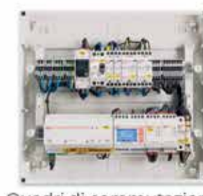
Quadri di commutazione rete/isola
